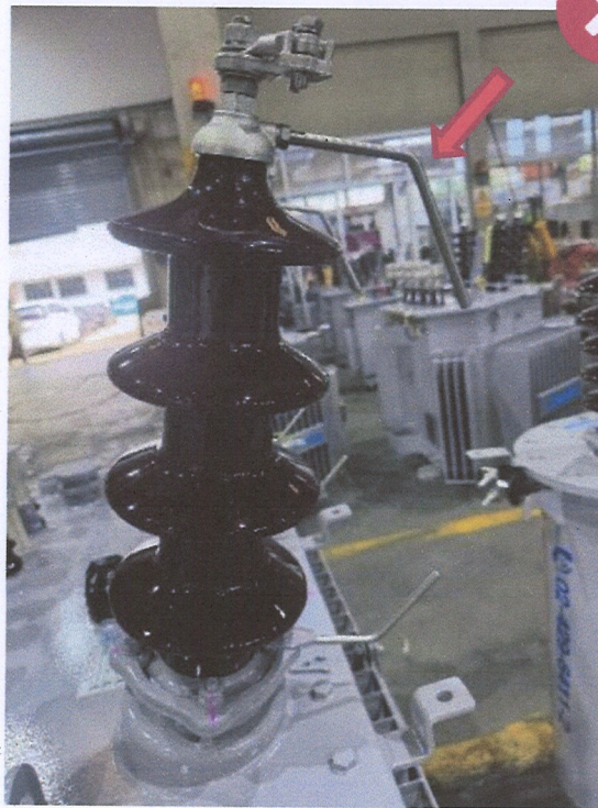
รูปที่ 10 ตัวอย่างการติดตั้งอาร์คชิ่งฮอรั่นบนบุชชิงด้านแรงดันสูง
