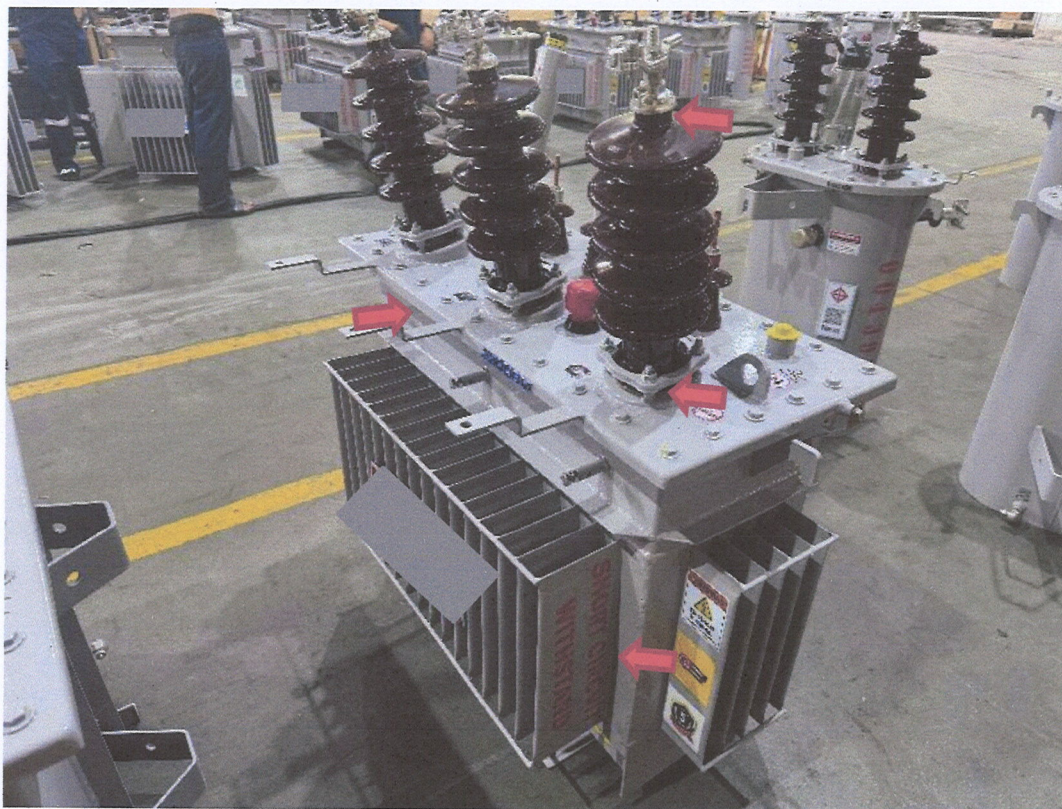
รูปที่ 17 ตำแหน่งการตรวจสอบการรั่วซึมของน้ำมันบนตัวถัง และบุชชิ่ง
