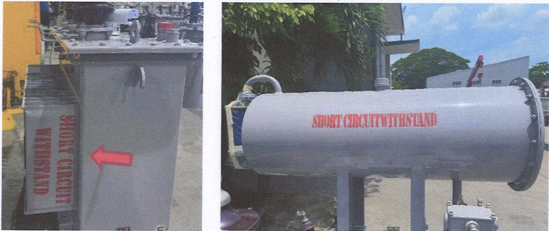
รูปที่ 13 แสดงข้อความ “SHORT CIRCUIT WITHSTAND” สีส้ม ทำบนตัวถัง
