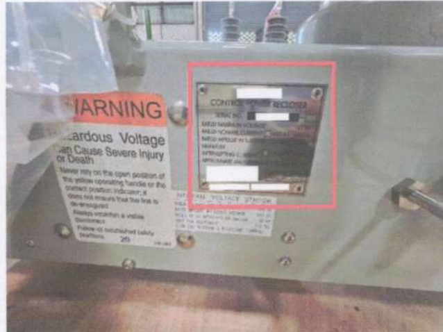
รูปที่ 13 ป้ายชื่อ (Nameplate)
