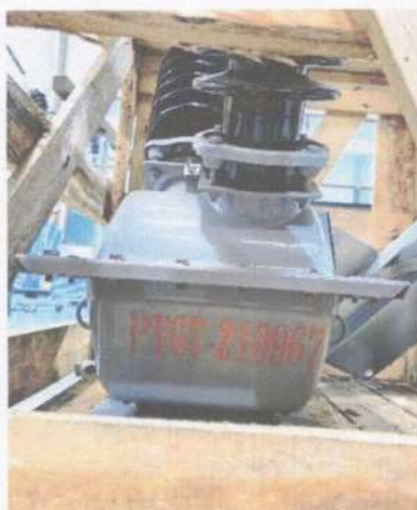
รูปที่ 25 ตัวอย่างหมายเลข PEA และเลขที่สัญญานบนหม้อแปลงแรงดัน
